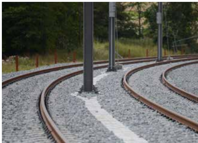
Eksempel på ballasteret spor, Aarhus Letbane. Foto: COWI
