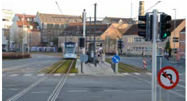
Eksempel på letbanetracé med asfaltbelægning og rilleskinner i krydsområde. Foto: Aarhus Letbane, COWI
